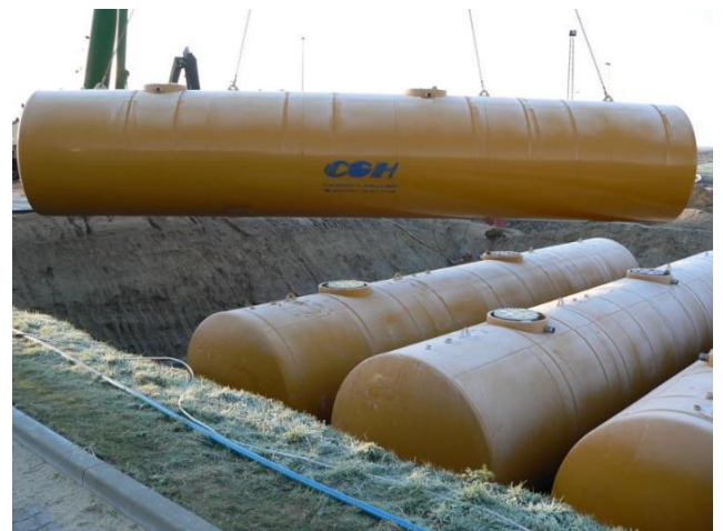
4 x 100 м 3 двустенные подземные резервуары
