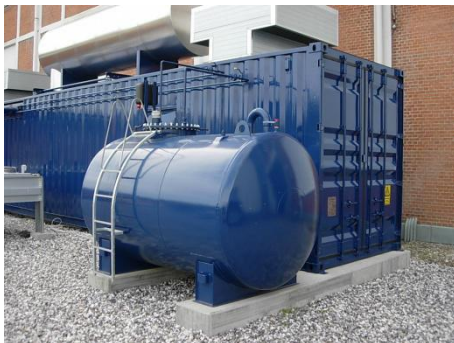
5 м 3 резервуар с диаметром 1600 мм.
